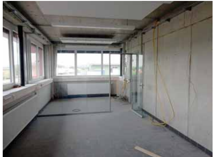
Lagebesprechung/Bereitschaftsraum mit Blick auf Funkraum welcher hinter dem Glaselement geplant ist.
