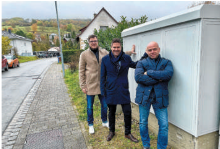
Felix Gieger (Firma Stiegeler), Bürgermeister Holger Mayer und Ortsvorsteher Stefan Rill, hier beim Verteilerkasten am Straßenrand (»Curb«), freuen sich über die Inbetriebnahme des Netzes in Binningen
