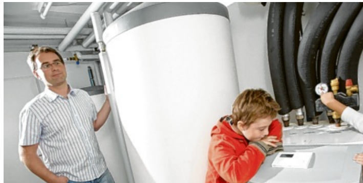
Die Heizung sollte zur Heizperiode gewartet werden.
