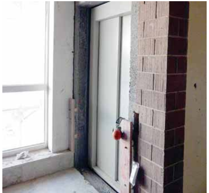
Auch die Aufzugsanlage ist bereits installiert.
