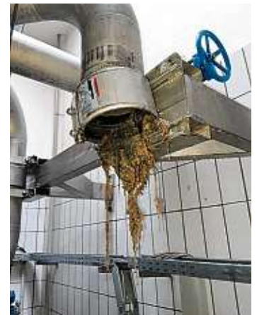
Die Feuchttücher verstopfen die Rohre und Pumpen.
