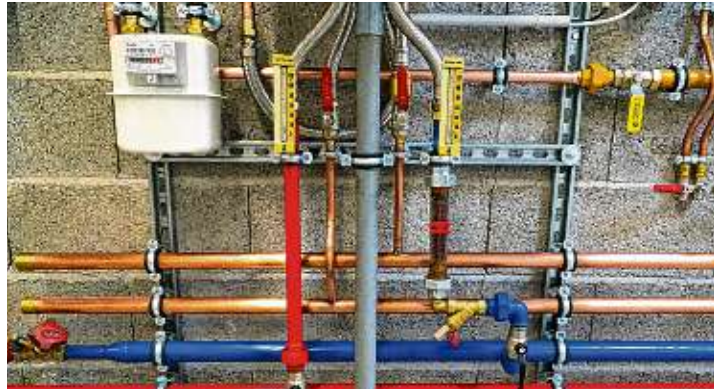
Auch die Wasserleitungen müssen stets instand gehalten werden.
