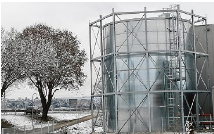
Der Sprinklertank wird mit Solarzellen verkleidet.
